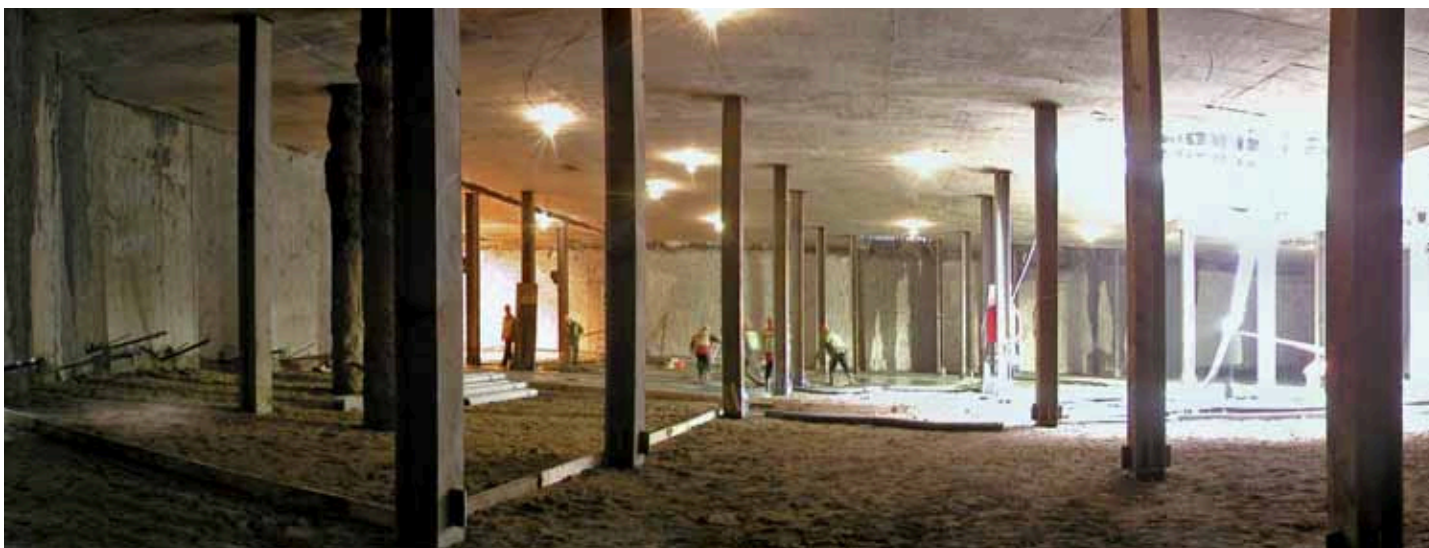
Panoramatický pohled do suterénu v úrovni 3. PP s oštrými podzemními stěnami, v zadní části probíhá pokládka podkladních betonů pro stropní desku 4.PP
