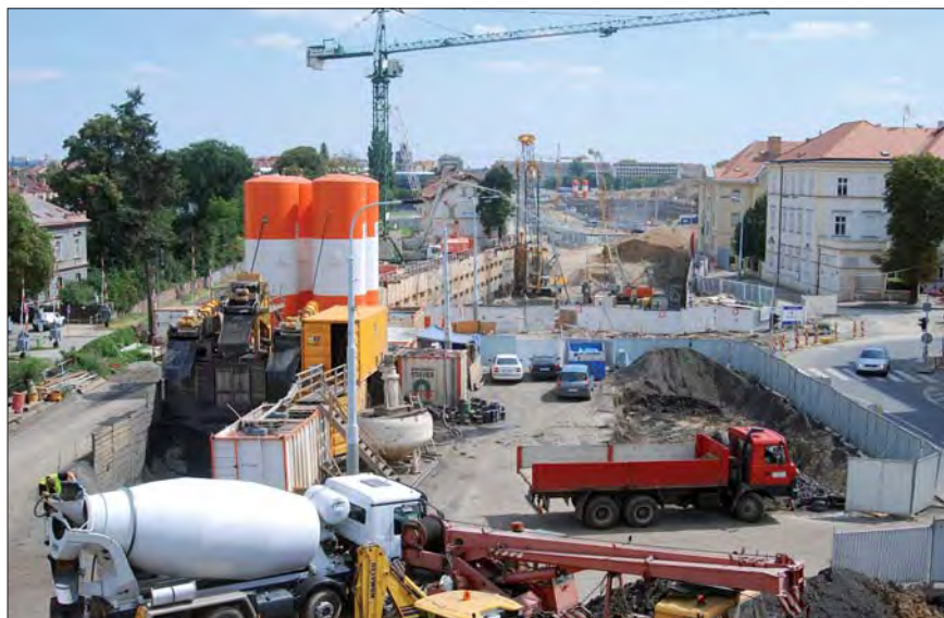
Pohled od stavby č. 0080 k Letné a navazujícímu úseku stavby č. 0079, kde probíhá těžba podzemních stěn frézou, vlevo dekantační zařízení
