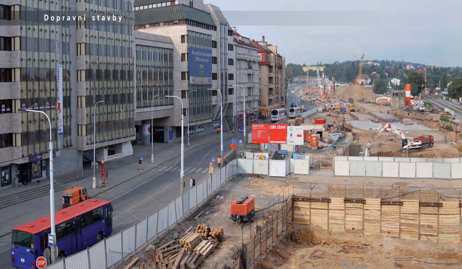
Stavební práce na třídě Milady Horákové, stavba č. 0080, pohled od Špejcharu na západ
