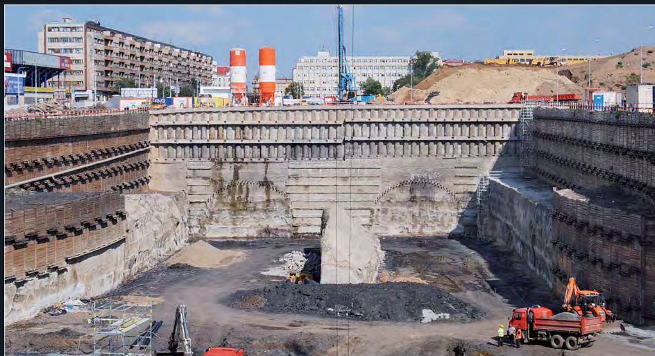
Zajištění portálové stěny kotvenou pilotovou stěnou (v horní části) v kombinaci s kotvenými mikropilotami a stříkaným betonem (ve spodní části), kde se nachází již skalní hornina. Vlastní profil tunelů je zajištěn ocelovými hřebíky a mikropilotovým deštníkem.
