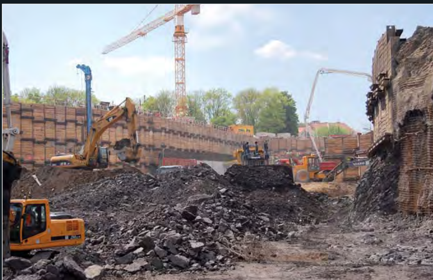
Probíhající těžba při postupném snižování výkopu v návaznosti na projektované kotevní úrovně ve stavební jámě, zajištěné v horní části záporovým pažením.
