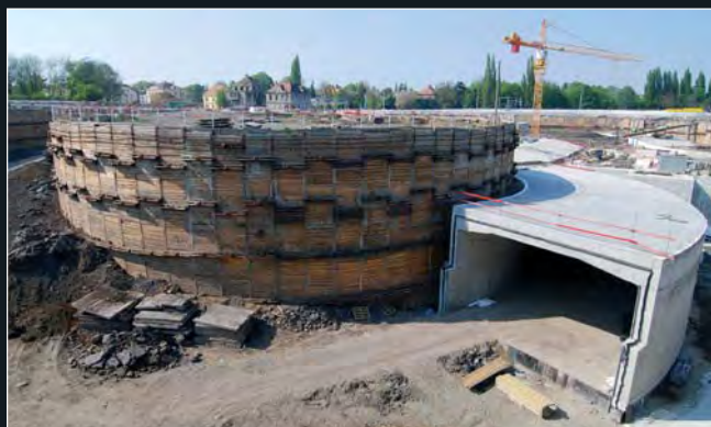
Pohled na oblast vjezdové a výjezdové rampy s poměrně komplikovaným pažením okolo sevřeného horninového masivu, kde bylo nutné kromě kotev k zajištění stability navíc použít i kotevní obruče a táhla.
