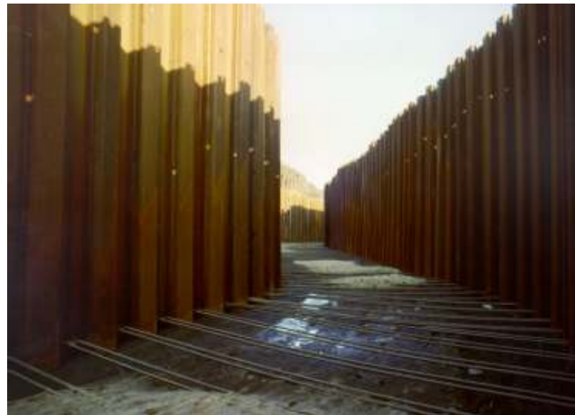
Dvojitá nasazená jímka spřažená táhly Double sheet pile wall cofferdam with rods
